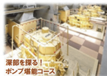
心臓部「ポンプ室」
